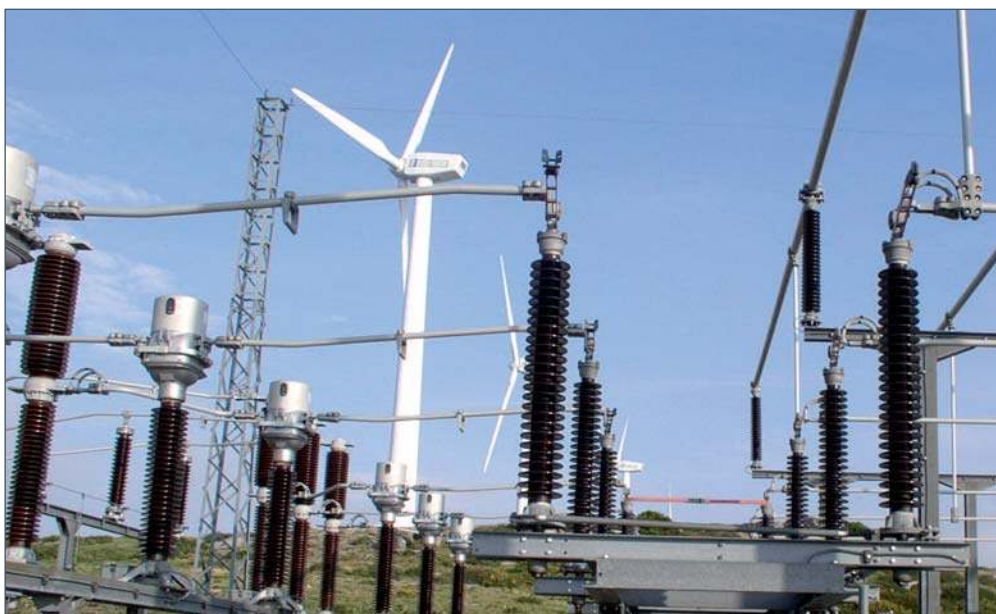
Imagen de un parque de intemperie en una subestación de parque eólico.
