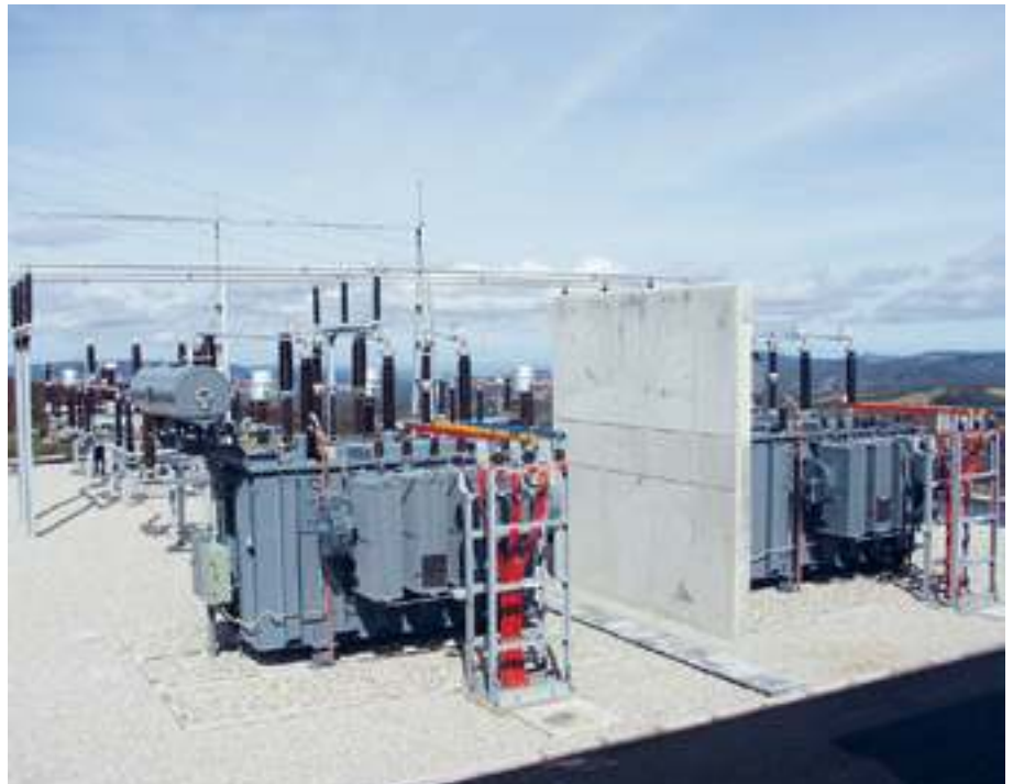
Subestación eléctrica de Elinsa en el parque eólico de Pena Luisa
